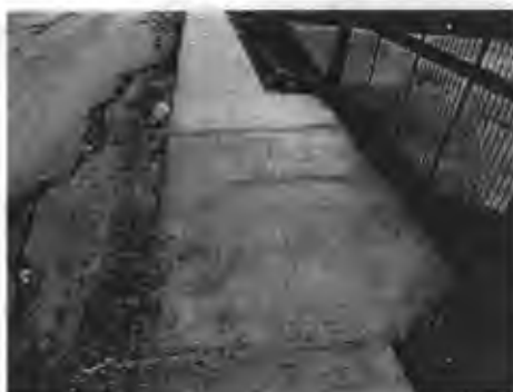
Fotografía N° 2: Detalle de otro acceso vehicular sin existir junta de dilatación.
