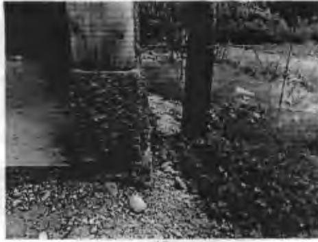
Fotografía N° 12: Detalle de la inexistencia del sobreecho de la fundación del refugio peatonal construido en el sector de Querelema.
