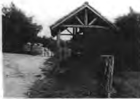
Fotografía N° 11: Elevación lateral del refugio de la localidad de Panilongo, verificándose que está emplazado parcialmente al interior de un terreno particular.
