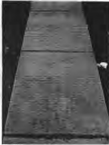
Fotografía N° 7: Ilustración de algunas fisuras superficiales en las veredas ejecutadas.
