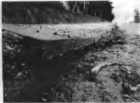
Fotografía N° 5: Detalle del socavamiento del material de base de las zarpas.
