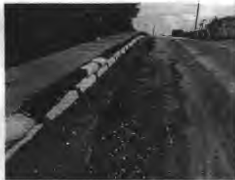
Fotografía N° 6: Vista general del relleno colindante de las zarpas, que ha generado el socavamiento de la base.
